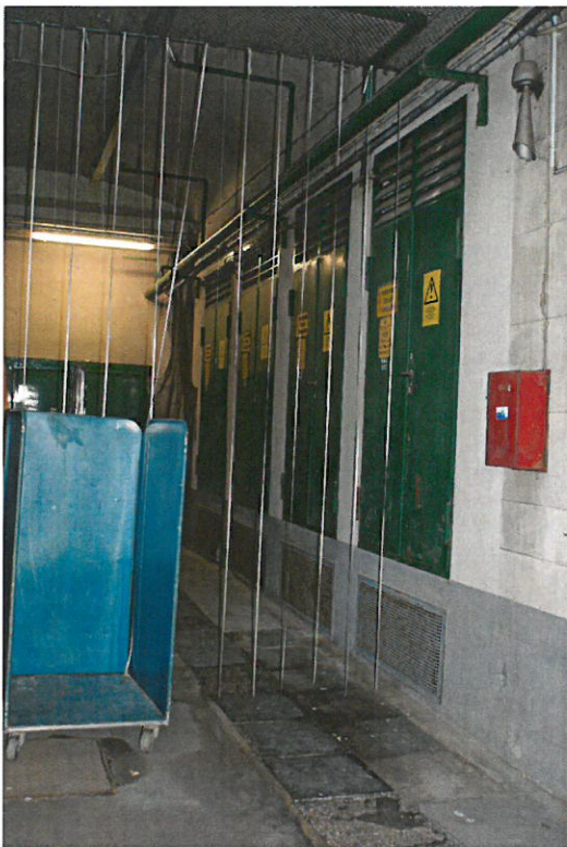
Abb. 8: Transformatoren östlich RKB 39 (in Betrieb)
