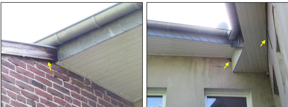
Abbildung 7: Spalt am Dachumlauf / Beschädigung und Spalt an Wand und Dachvorsprung
