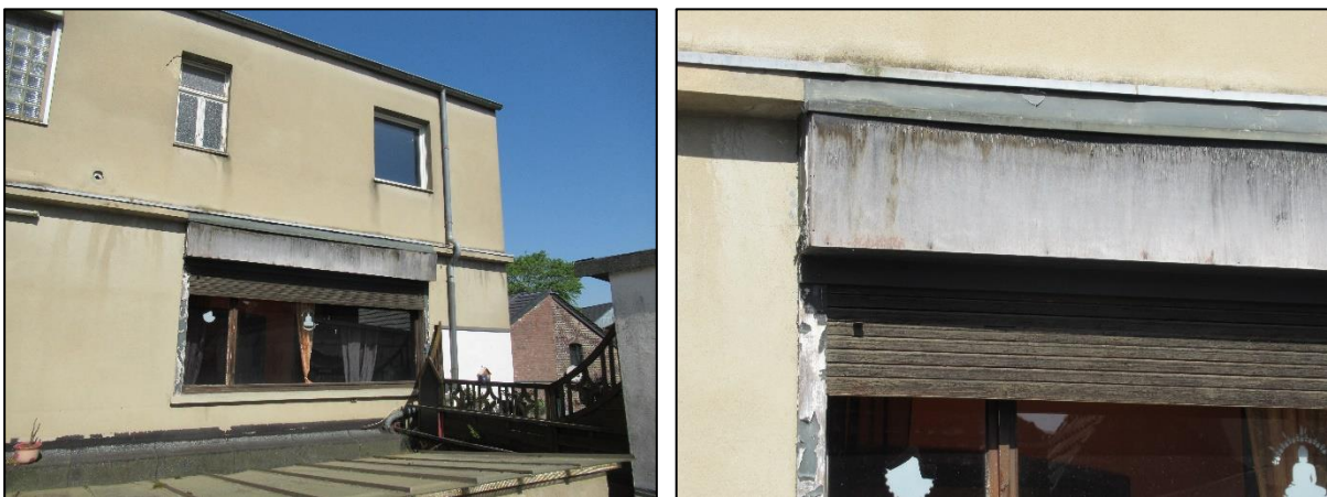
Abbildung 9: Spalt am Rollladenkasten
