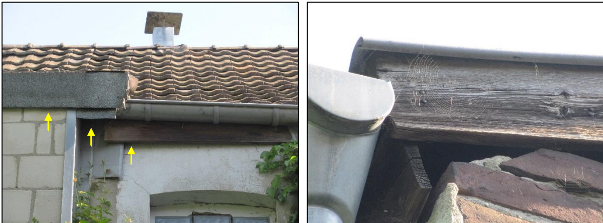
Abbildung 6: Nische und Spalten am Dachumlauf aus Dachpappe und Holz / Beschädigung am Dachumlauf
